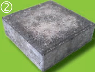
Ausblühungen nach z.B. 3-9 Monaten
