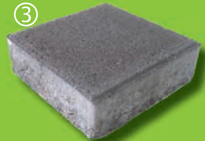
Nach Abwitterung der Kalkausblühungen
